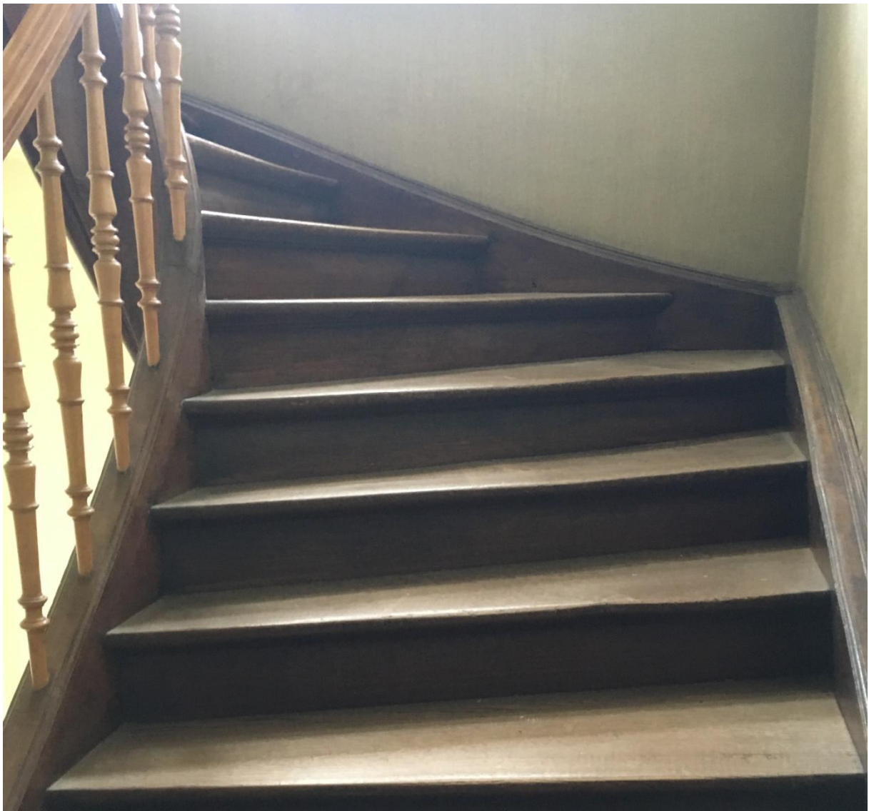
Treppe zum 4. OG noch Originalzustand >> Eiche altersentsprechend abgelaufen
