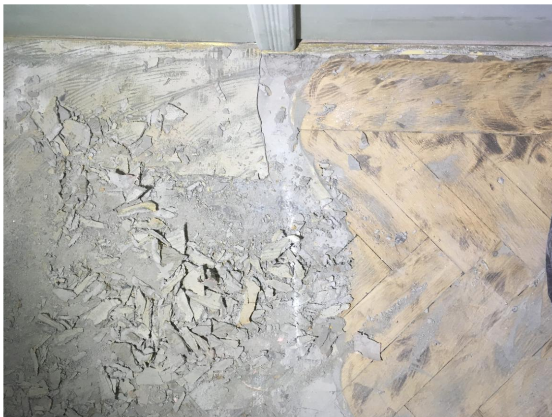
Auf allen Stufen und Podesten wurde der ca. 6 – 10mm dicke Zementfaser-Spachtel entfernt
