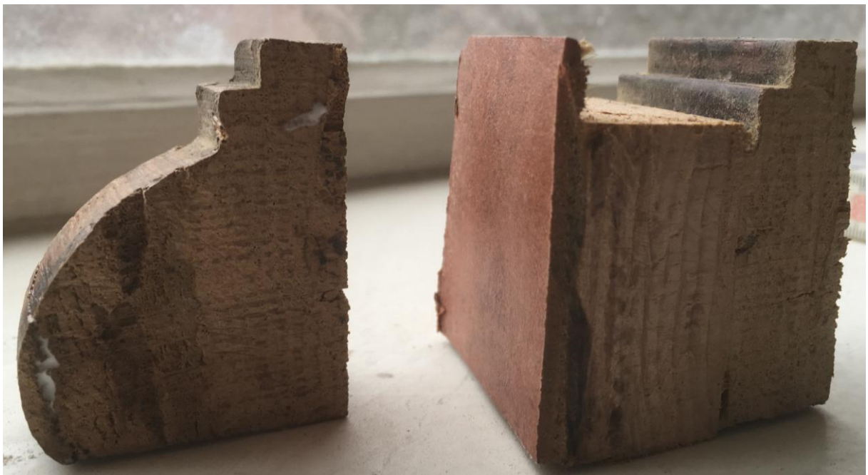
Originalprofilkante – wurde beim Belegen mit Linoleum an allen Stufen abgesägt und durch ein Vierkantholz ersetzt
