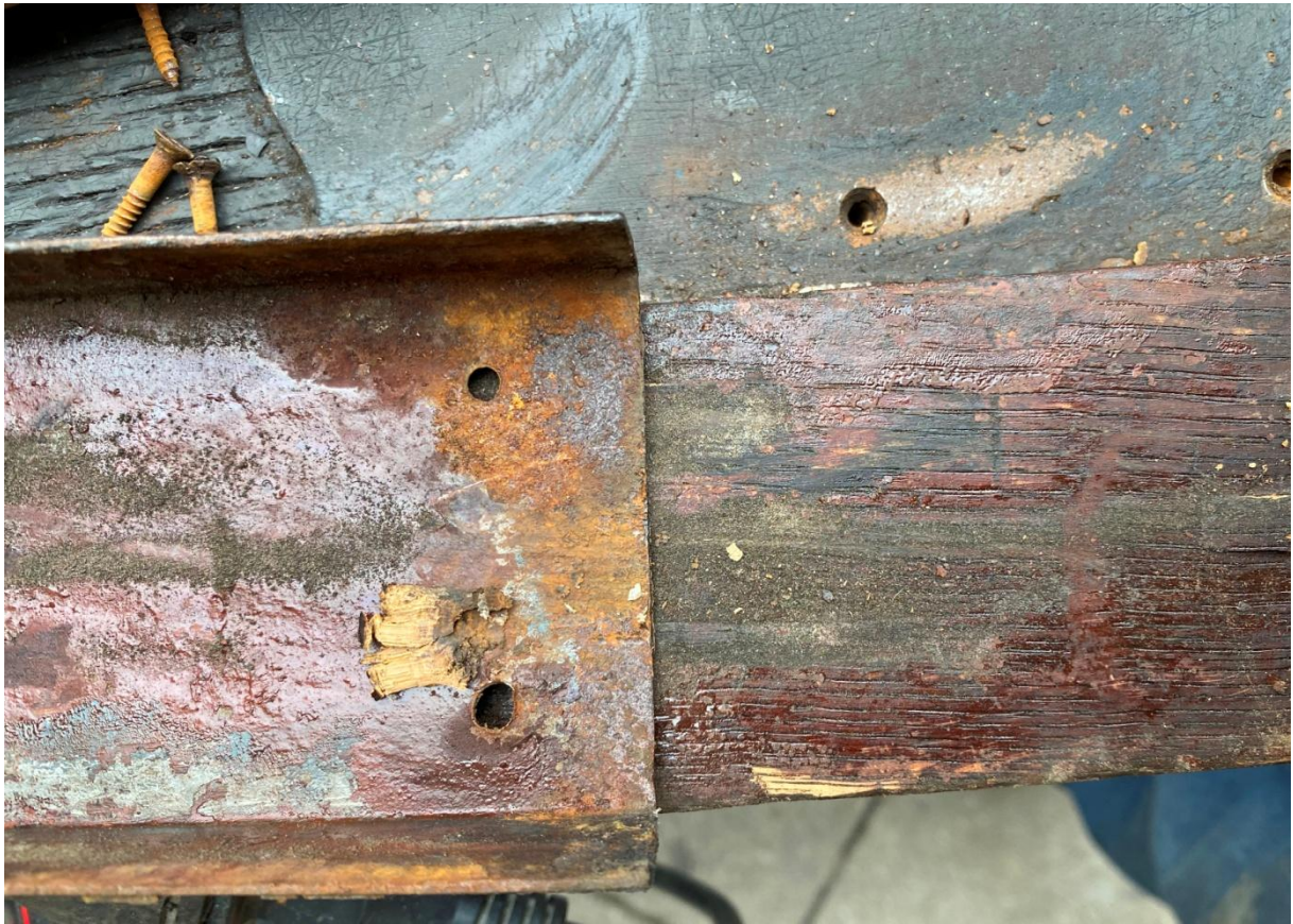
Rot unter den Stoßblechen
